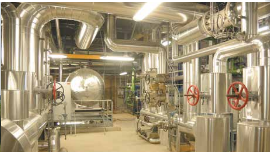
Chaufferie biomasse en fonction depuis 2012 au sud d'Orléans, à La Source.
