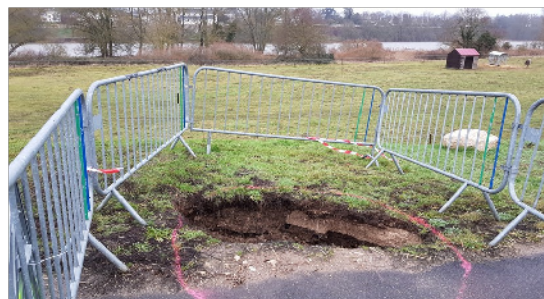
Val d'Orléans – janvier 2018 Karst dans la digue à Saint-Pryvé-Saint-Mesmin
